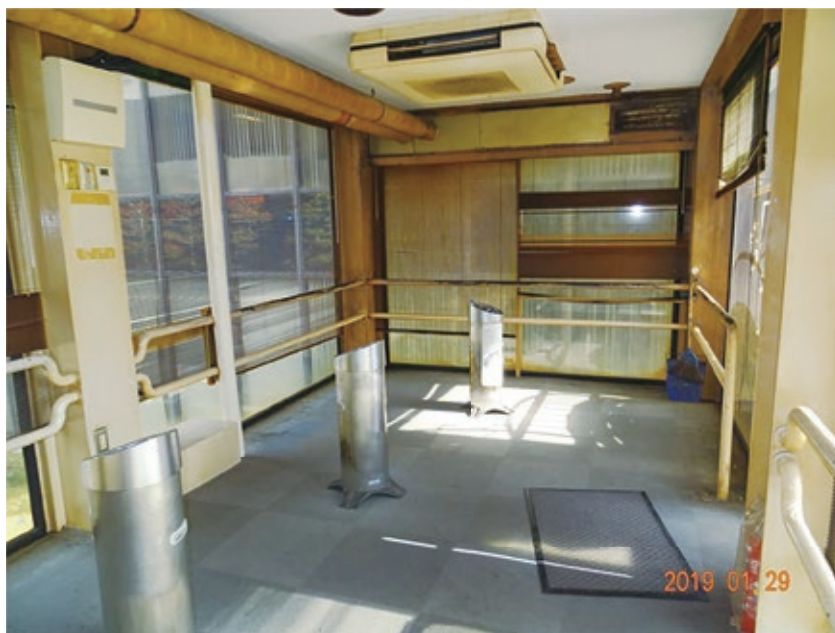
図5. 北九州市本庁舎の喫煙コーナー 議会棟との連絡通路2階の喫煙室、大量のヤニが付着
